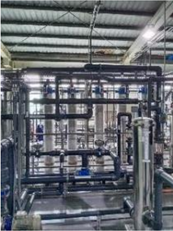
正面 TMF 中水回收設備
