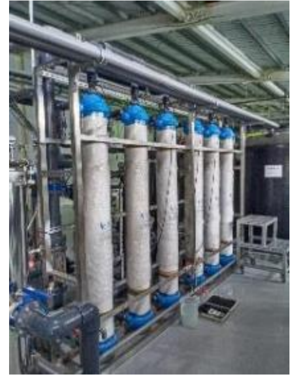
背面 TMF 中水回收設備
